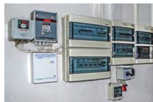
Sterownia automatyczną w nowym kurniku
